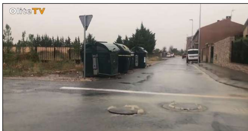
Ilustración 38. Imagen del inicio de la inundación en un punto bajo de Olite, a través del retorno del agua por la red de alcantarillado, añadiéndose el riesgo de que se desplacen las tapas de su lugar.
