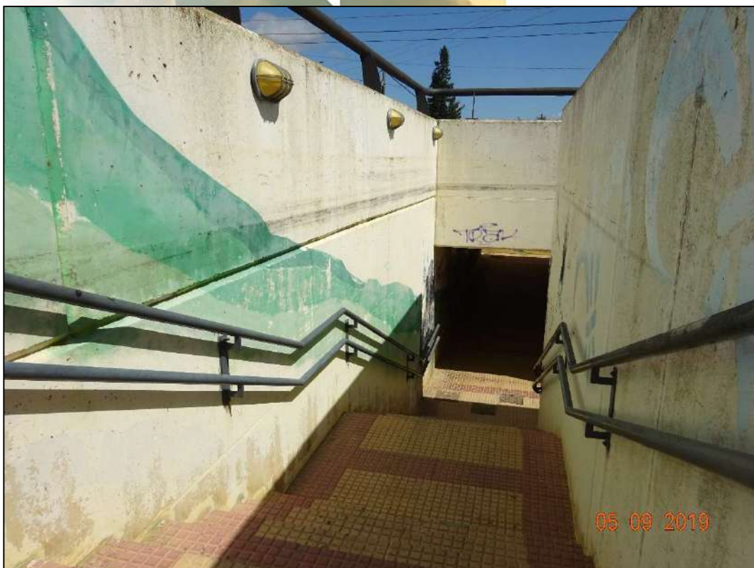
Ilustración 56. El paso bajo las vías del tren, situado al final de la Avenida de San Martín de Unx, resultó completamente inundado, tal y como se ilustra en estas dos fotografías.
