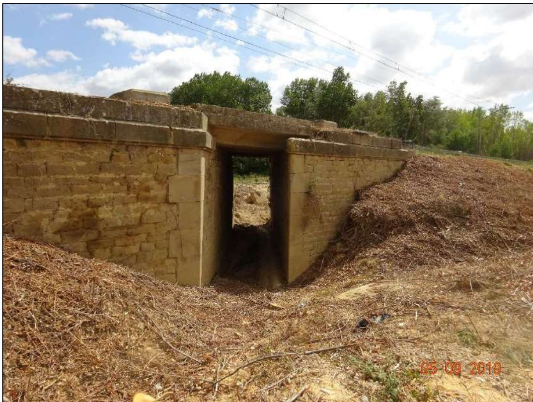
Ilustración 48. Infraestructuras longitudinales, aguas arriba del casco urbano de Olite, que no tuvieron la suficiente capacidad hidráulica para dejar fluir la riada que se originó el 8 de julio de 2019. El puente de las vías del tren supuso un obstáculo que favoreció el desbordamiento – en ambos márgenes - en este punto.
