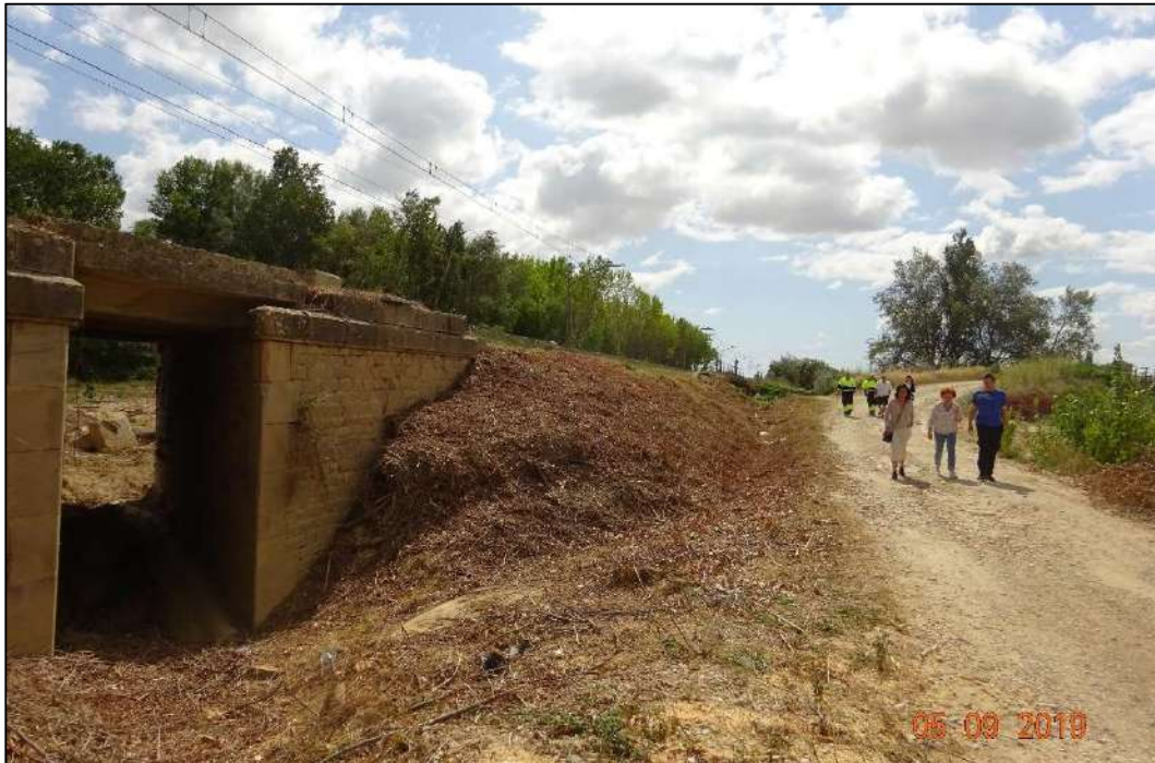
Ilustración 49. Zona, aguas arriba del puente de las vías del tren, por la que se dieron los desbordamientos hacia puntos más bajos en la margen izquierda del Cidacos.
